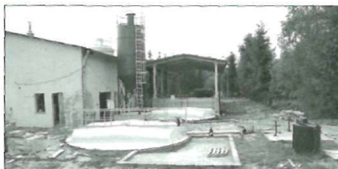
Węzeł higienizacji osadu – stacja odwadniania osadu, zagęszczacz osadu
